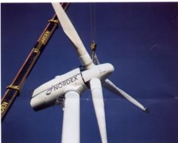
Nordex 2,5 MW , promjer rotora turbine je 80 metara.
